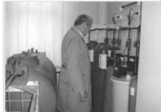
Фото 5. Технологія попередньої очистки води для гемодіалізу.
